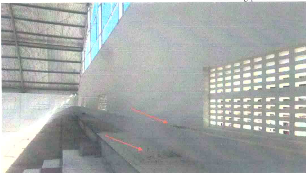
Foto 8 – Fezes de pombo arquibancada com 1ª demão de tinta.
