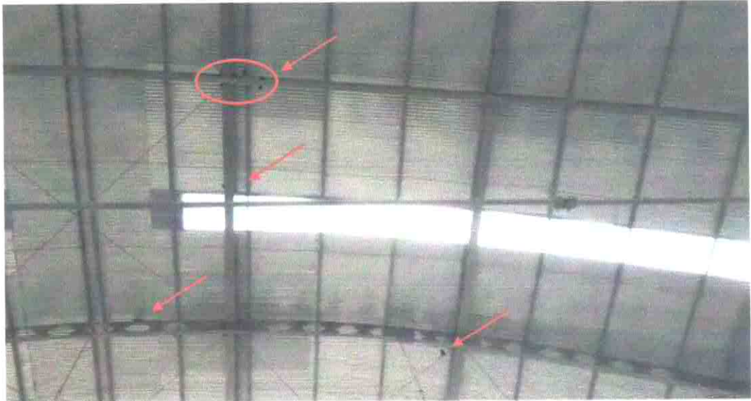
Foto 1 – Pombos na estrutura metálica da cobertura do Ginásio Lourival Batista.
