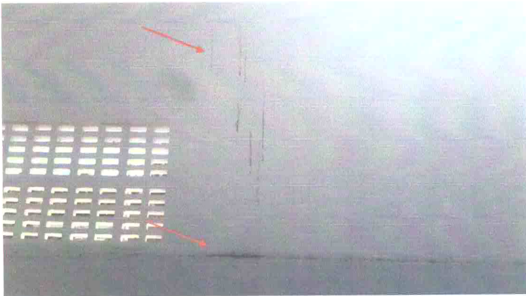
Foto 7 – Fezes de pombo sobre parede após execução de pintura.
