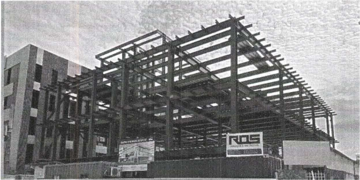
- Obra Concluída - Sesc Brasil (Aracaju/Se) - Outubro/2021 - Fabricação E Montagem De 200.000,00kg (200 Toneladas) De Estrutura Metálica
