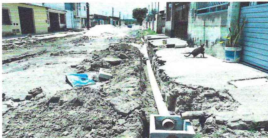
Tubulação e Caixa de passagem
