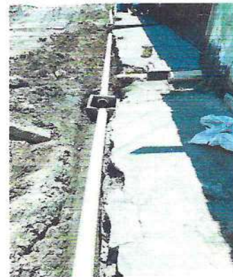
Tubulação e Caixa de passagem
